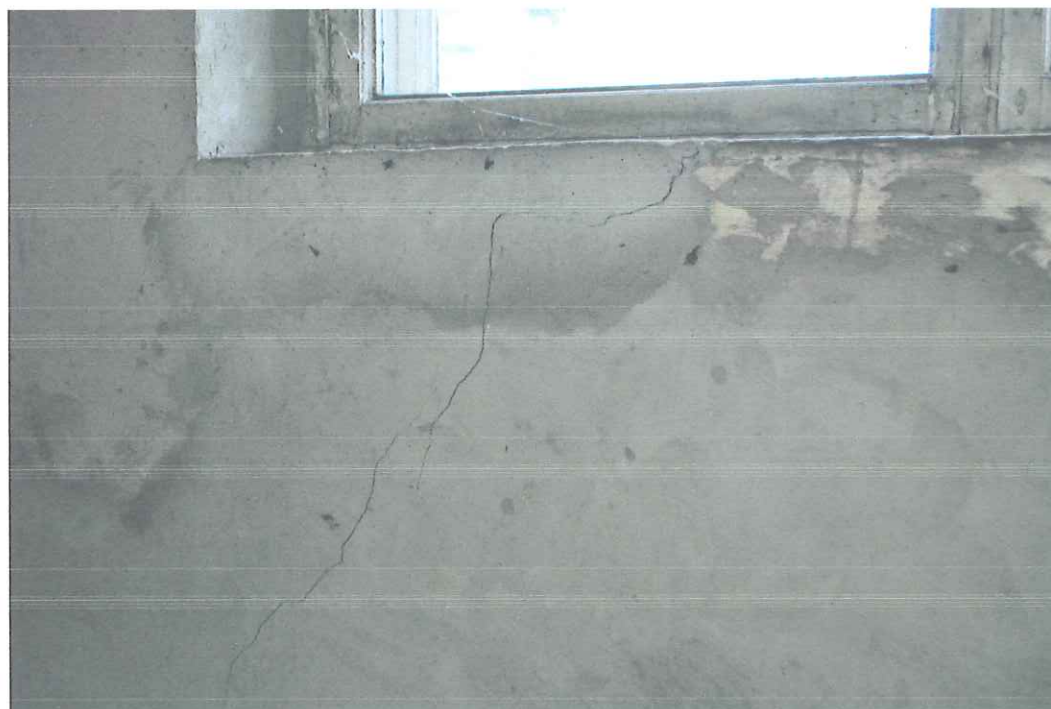
Pęknięcie ściany zewnętrznej poniżej okna.
