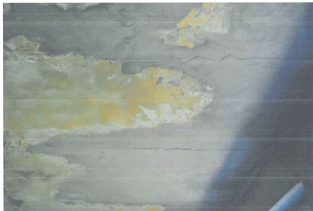
Pęknięcia i zacieki na stropie wiatrołapu.
