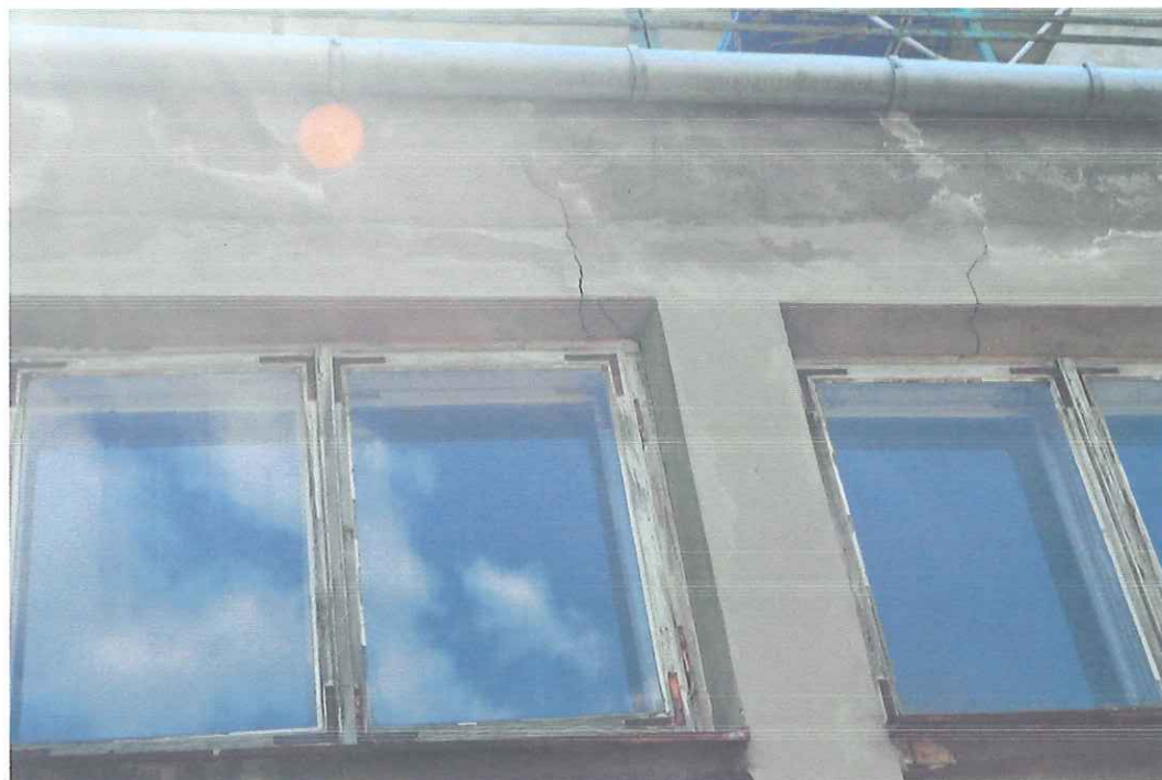
Pęknięcia nadproży na elewacji północnej.
