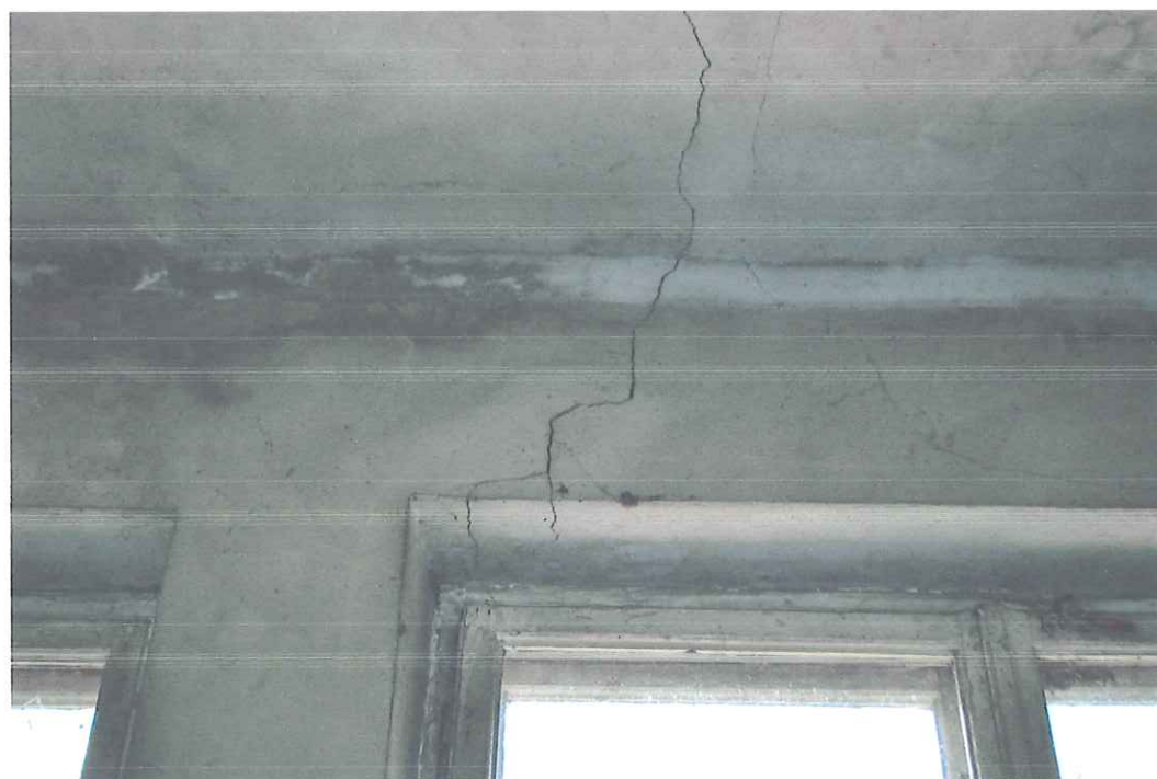
Pęknięcie stropu przechodzące w pęknięcie nadproża okiennego.
