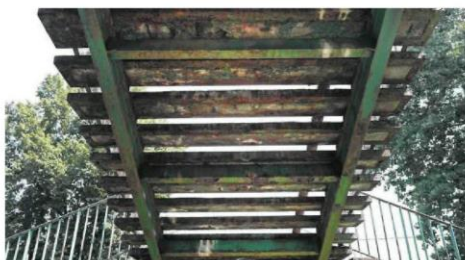
• Rdzewiące kładki nad al. Wojska Polskiego zostaną zastąpione konstrukcjami podwieszanymi
