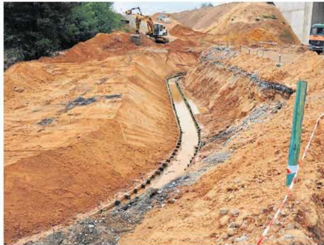
GDDKiA zapewnia, że na odcinku F autostrady A1 trwają intensywne prace budowlane
