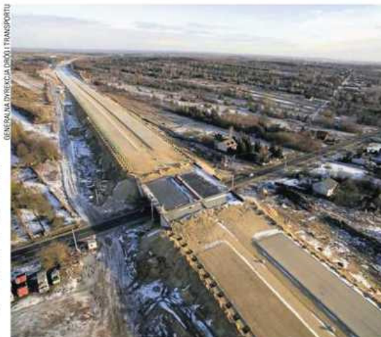
Tak na początku roku wyglądał fragment odcinka F autostrady A1 między węzłami Częstochowa Północ a Częstochowa Blachownia
