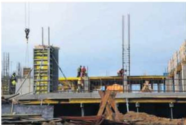
Konstrukcja aquaparku rośnie w szybkim tempie. Na placu budowy pracuje kilkudziesięciu robotników
