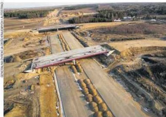
Tak na początku roku wyglądał fragment odcinka F autostrady A1 między węzłami Częstochowa Północ a Częstochowa Blachownia
