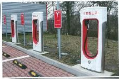
Katowice zainwestowały m.in. w stacje ładowania Supercharge dostarczone przez Teslę
