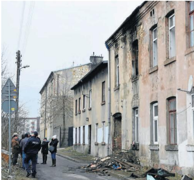
Budynek, w którym doszło do pożaru, nie nadaje się do użytku. Prawdopodobnie czeka go rozbiórka
